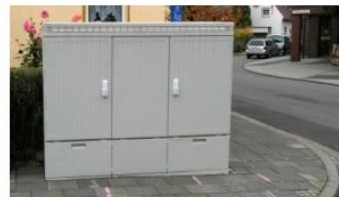
Kabelverzweiger der Deutschen Telekom (Bild: FEXX/CC0 1.0)
